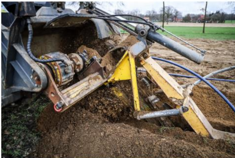
Die Leitungen für die Wärmepumpe mit Flächenkollektor wurden in die Erde eingefräst. So war der Eingriff in das Bodengefüge möglichst gering und das Erdreich musste nicht aufgebaggert werden. (Bild: Privat)
