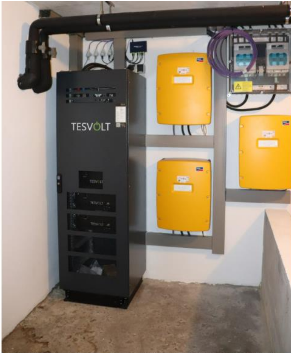
Der Batteriespeicher besteht aus acht Fächern, sechs davon sind aktuell in Gebrauch, d.h. zwei könnten Schulze Spüntrup noch nachrüsten. (Bild: Meinert)
